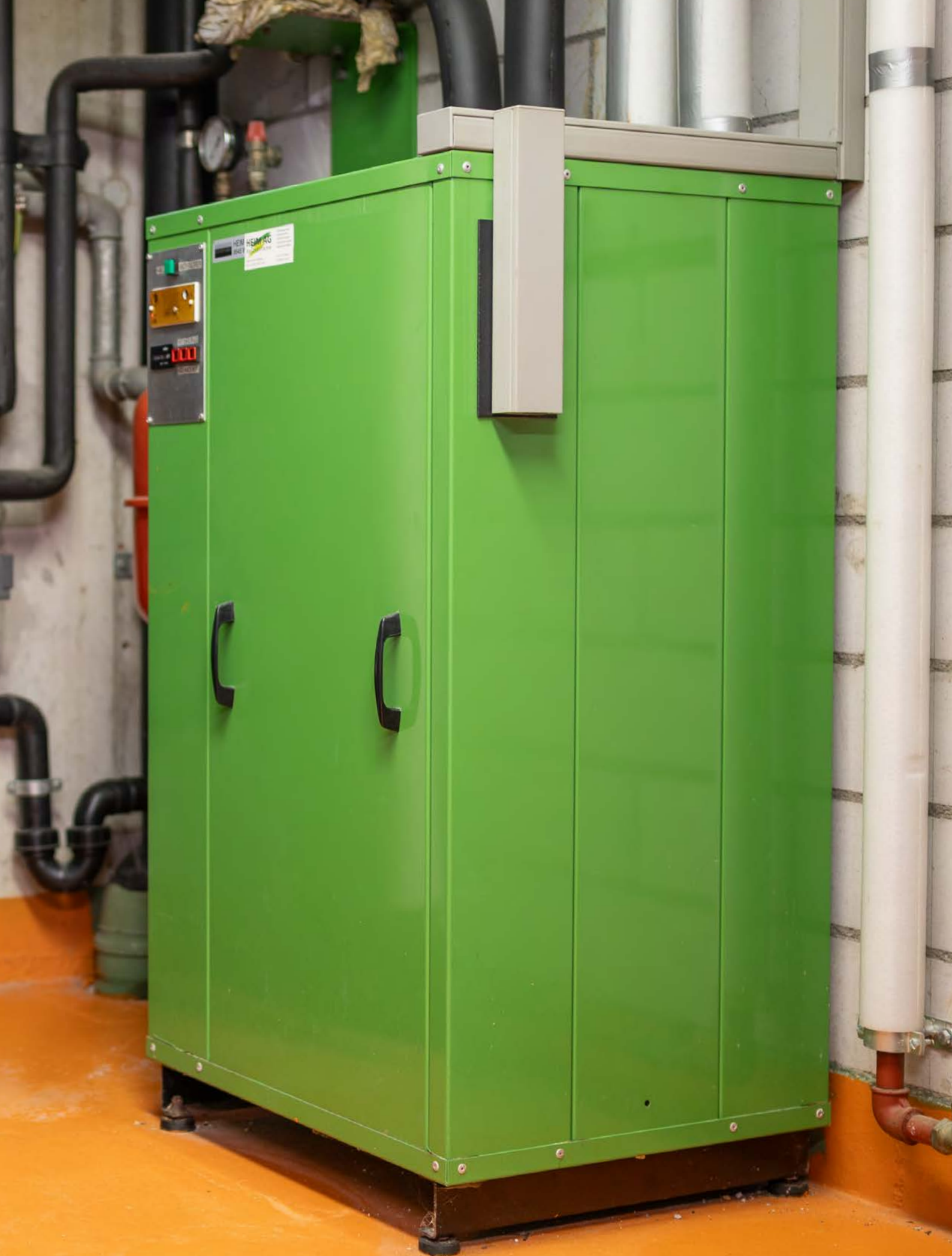
Erste Heim-Wärmepumpe – installiert im Jahr 1989
